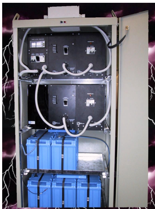
Stazione di energia SETB 2000-6-R
